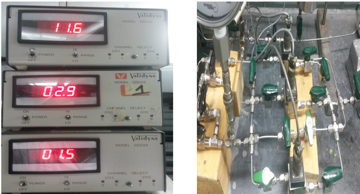
Figura 32. Transductores de Presión
