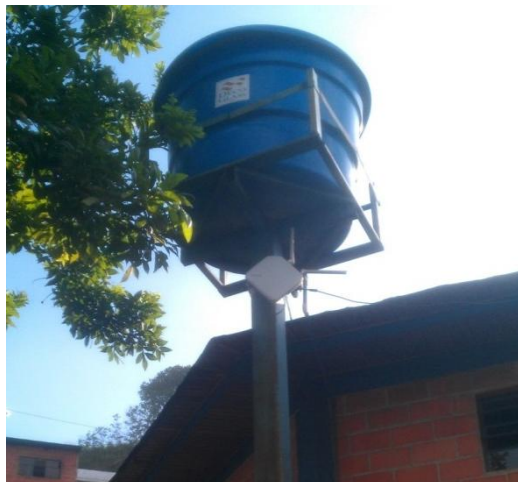
Figura 36. Equipo AP6510 instalado en Plaza 4F, Parroquia 23 de Enero.
