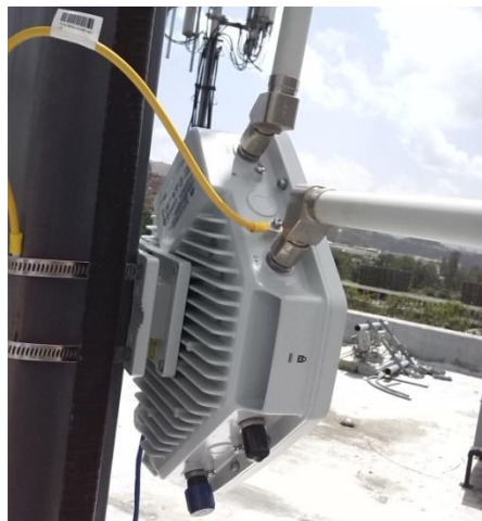
Figura 35. Equipo AP6510 instalado, segunda toma. Plaza Padre Manuel Aguirre.
