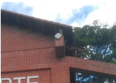
Figura 37. Equipo AP6510 instalado en Parque del Oeste (Parque Ali Primera),
