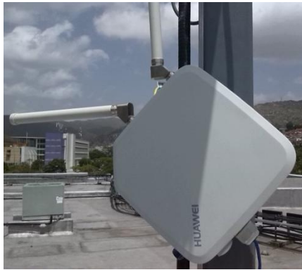
Figura 34. Equipo AP6510 instalado en la Plaza Padre Manuel Aguirre. Parroquia La Vega
