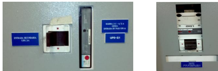
Figura 46: Interruptor secundario de entrada y salida UPS 2.1
