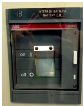
Figura 50: Interruptor del banco de batería.
