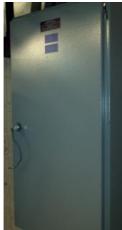
Figura 34: Tablero de Aires Acondicionado (TAA-Sot)
