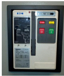
Figura 26: Interruptor de enlace del tablero de transferencia (TPTC).
