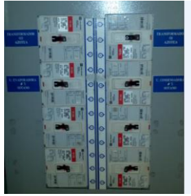
Figura 35: Interruptor del tablero de Aires Acondicionado (TAA-Sot)
