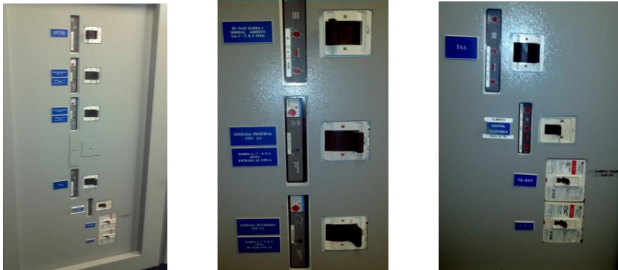
Figura 20: Interruptores del gabinete A del tablero TPTC
