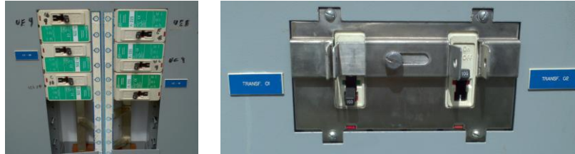
Figura 37: Interruptor del tablero de Aires Acondicionado (TAA-Azotea)
