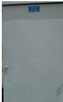
Figura 38: Tablero de Aires Acondicionado (TAA)
