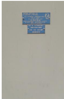
Figura 36: Tablero de Aires Acondicionado (TAA-Azotea)
