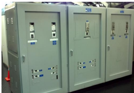
Figura 28: Tablero de PDU (T-PDU)
