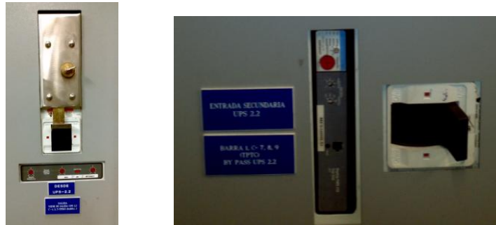
Figura 53: Interruptor secundario de entrada y salida UPS 2.2.
