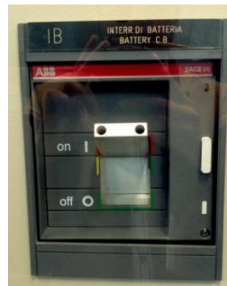
Figura 43: Interruptor del banco de batería.
