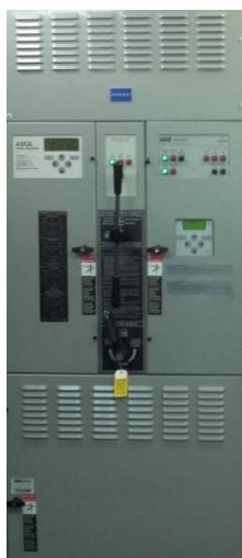
Figura 14: Dispositivo de transferencia acometida 2
