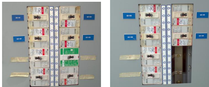
Figura 39: Interruptor del tablero de Aires Acondicionado (TAA)
