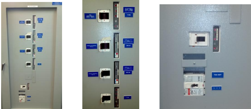
Figura24: Interruptores del gabinete E del tablero TPTC
