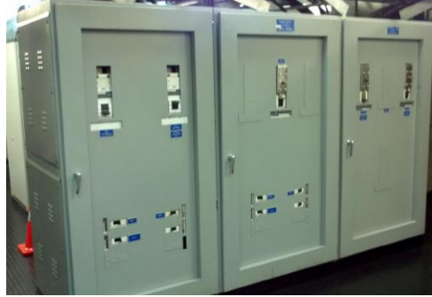
Figura 31: Tablero de PDU (T-PDU)
