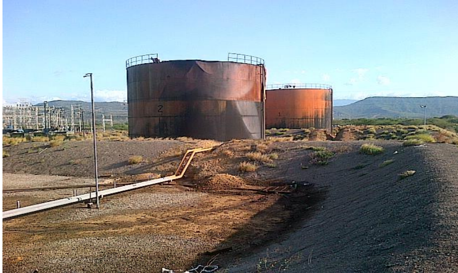
Figura N°14: Incidente en el tanque de almacenamiento de combustible.
