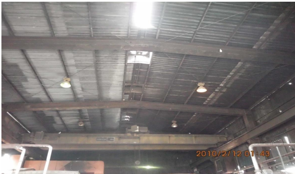
Figura N°8 Sistema de Iluminación.
