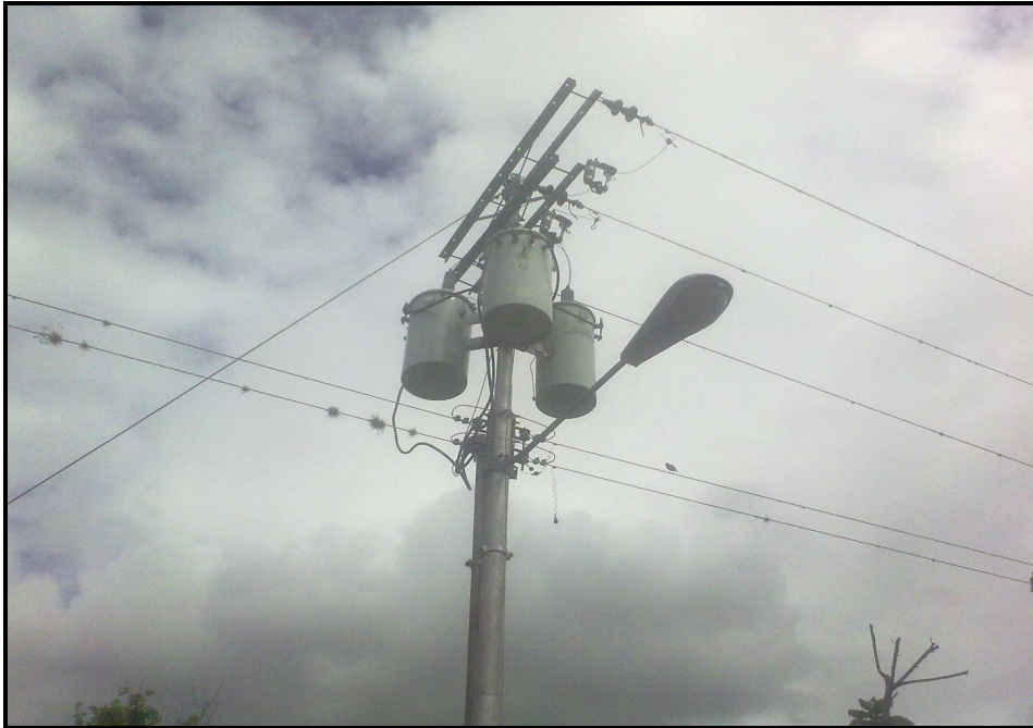
Muestra de grupo de transformación en condiciones óptimas, no presenta corrosión ni escape de aceite dieléctrico/refrigerante
