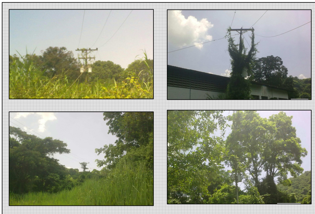
Evidencia de la situación actual de la red de distribución de la UCV-Maracay
