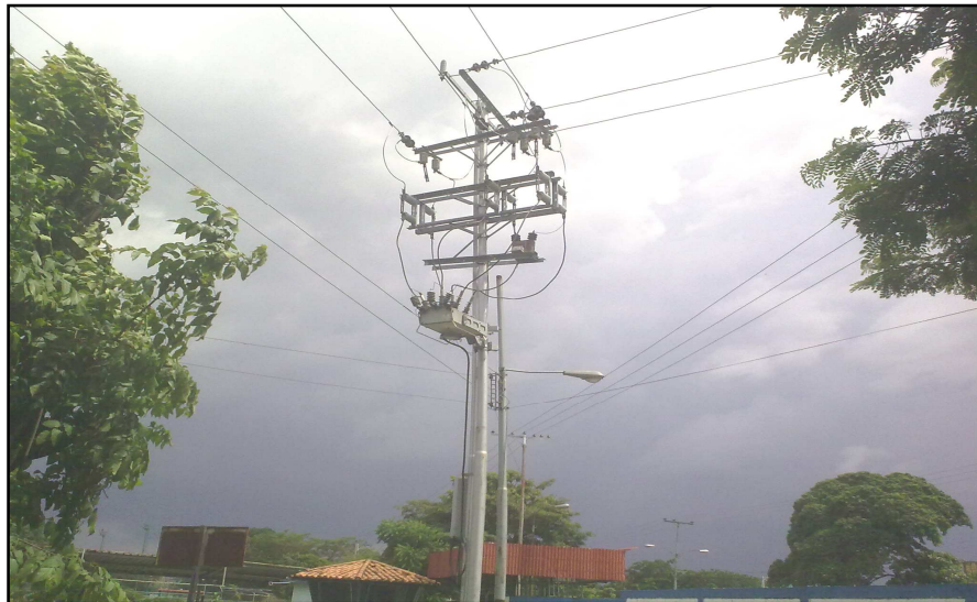
Figura 8. Reconectador NOJA POWER campus de la UCV-Maracay
