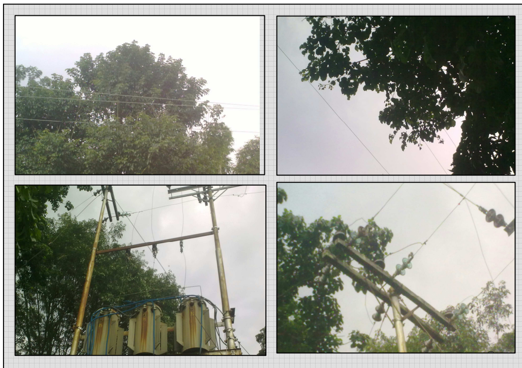
Evidencia de la situación actual de la red de distribución de la UCV-Maracay
