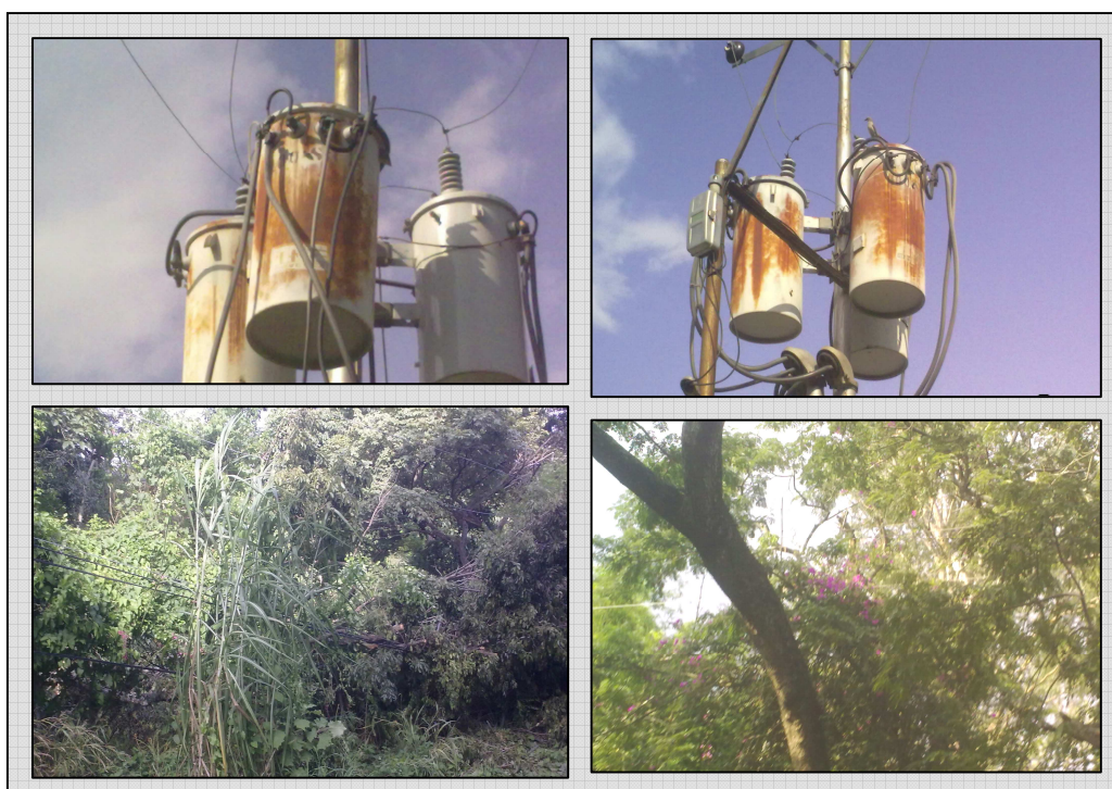
Evidencia de la situación actual de la red de distribución de la UCV-Maracay
