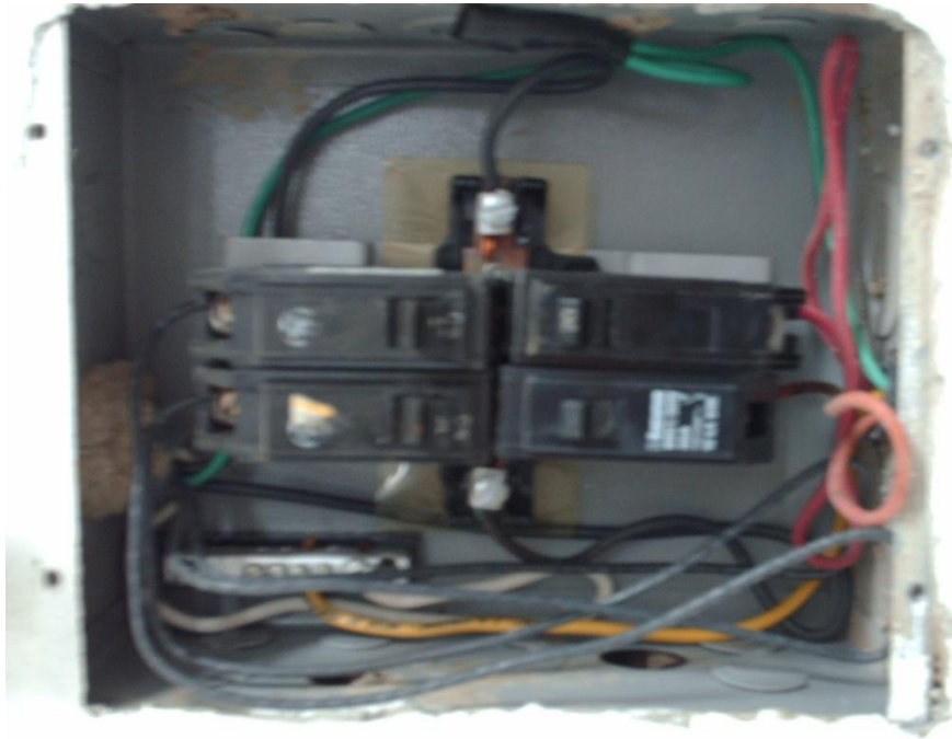
Figura 19 Tablero del circuito de los equipos de la radio base
