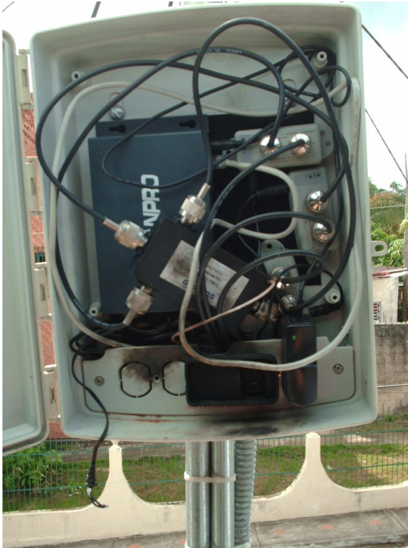
Figura 14 Detalle de caja de intemperie con equipos inoperativos.
