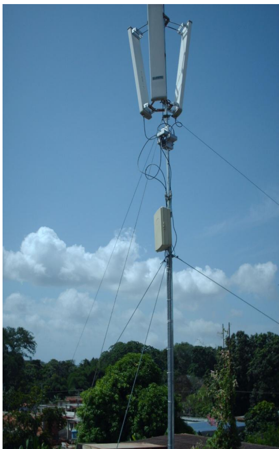
Figura 20 Aspecto de la instalación externa en la radio base de la biblioteca pública en Curiepe
