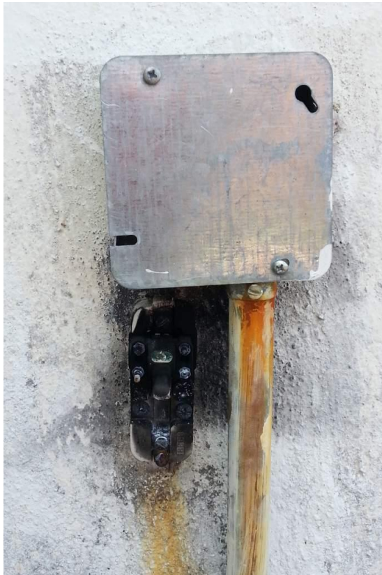
Figura 17 Detalle del cajetín de distribución e interruptor de energía hacia la caja de intemperie
