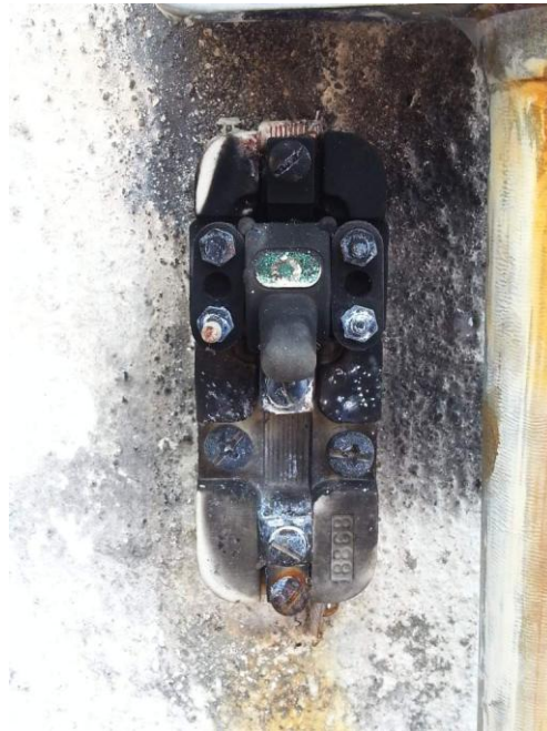
Figura 18 Detalle del interruptor inoperativo.
