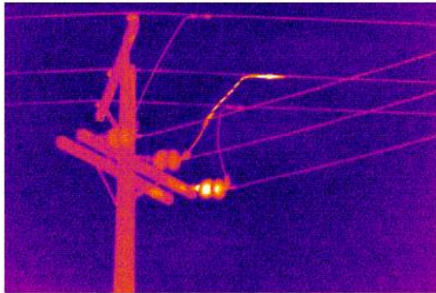
Figura 5.2: Imagen termográfica con punto caliente[28]
