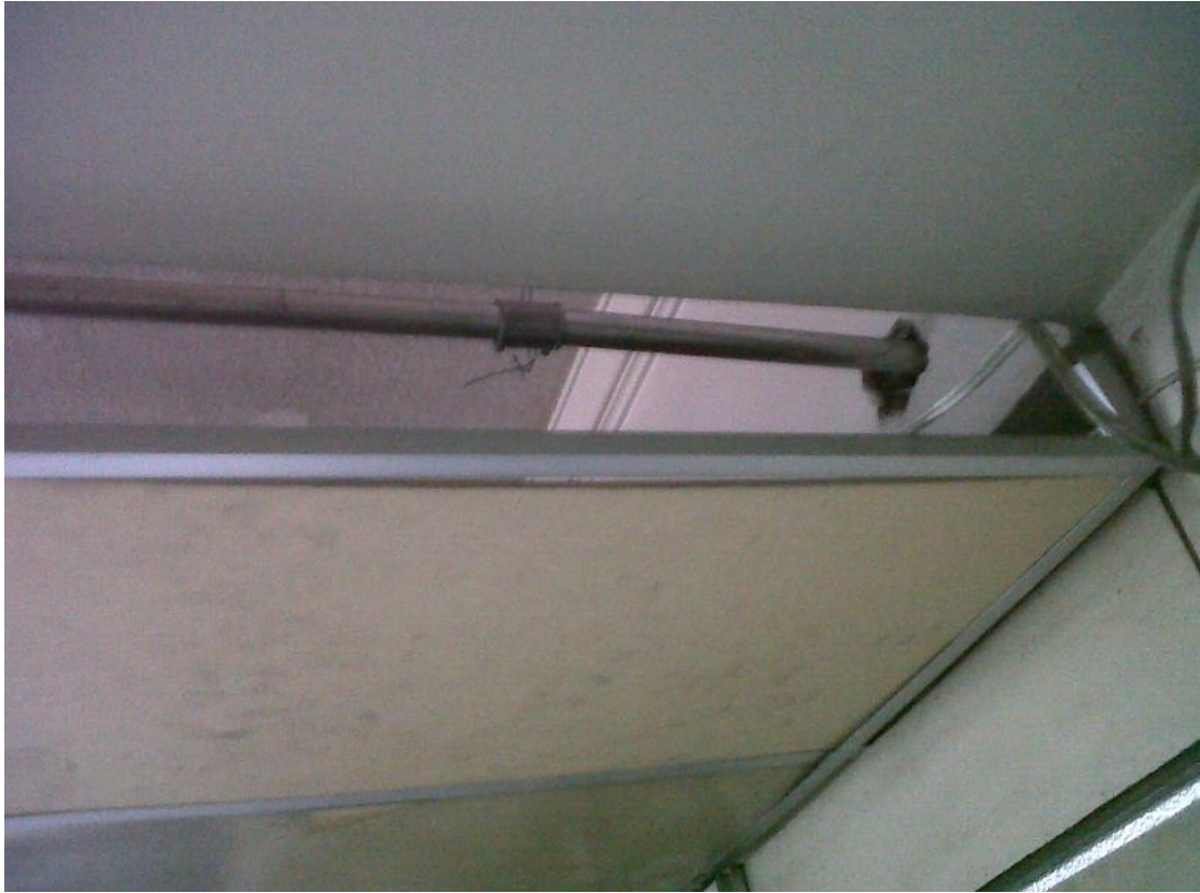
Figura 13. Picca, L. (2015) Tuberías, Archivo de la DGEAPC
