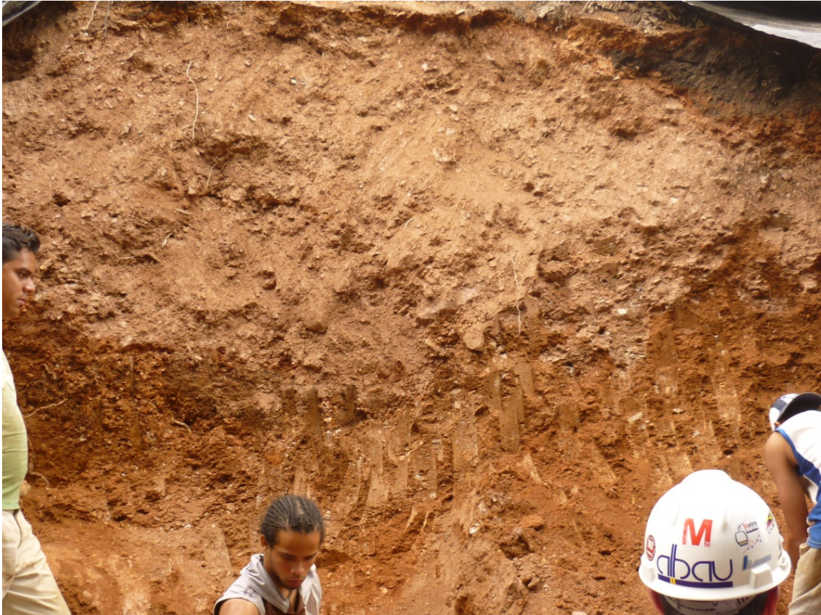
Figura 4.7. Vista en campo de materiales granulares color marron con anaranjado arrastrados por el flujo. Se observan un grupo de obreros trabajando para la estabilización del talud ubicado en las Colinas de San Román.
