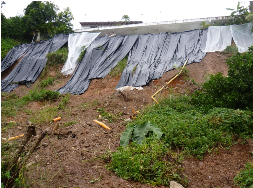
Figura 4.2. Talud ubicado en la avenida AC, con evidencias de desprendimiento de partículas y deterioro del terreno. En la parte superior se observan plásticos colocados sobre el material que sirve como manto impermeabilizante para evitar que el terreno sature producto al agua.
