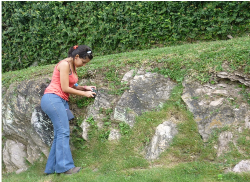
Figura 4.18. Vista del horizonte II. Se observa planos de diaclasas bien representativos y se hizo la medición en uno de ellos. Este frente se presenta como fachada de una vivienda con el nombre Quinta Concheta.
