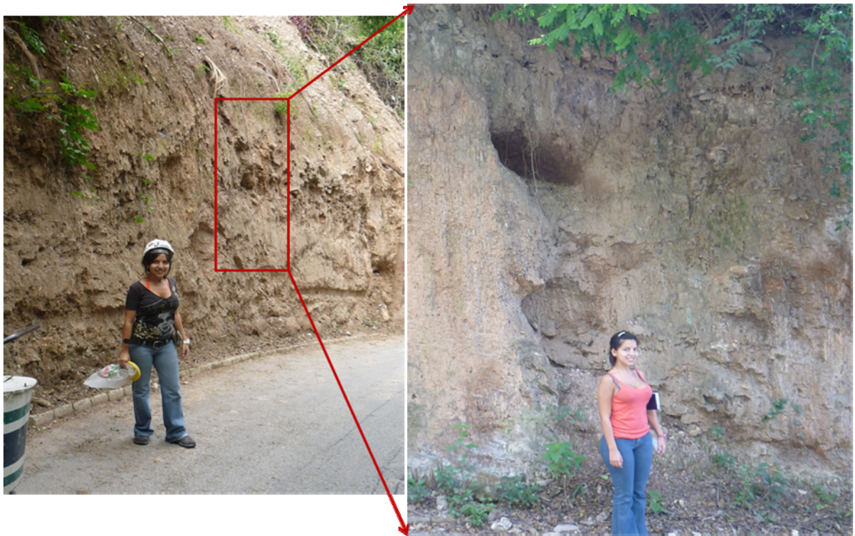
Figura 4.15. Vista en campo del horizonte I-A, nótese la descomposición física de la roca a tal punto en llegar a convertirse en suelo residual, las cuales modifican sustancialmente los parámetros de resistencia y permeabilidad. Se observa al pie del talud material acumulado por arrastre y descascaramiento y en la parte superior se observa horadaciones formadas por la percolación del agua durante escorrentías o por las pasadas lluvias intensas en la Capital.
