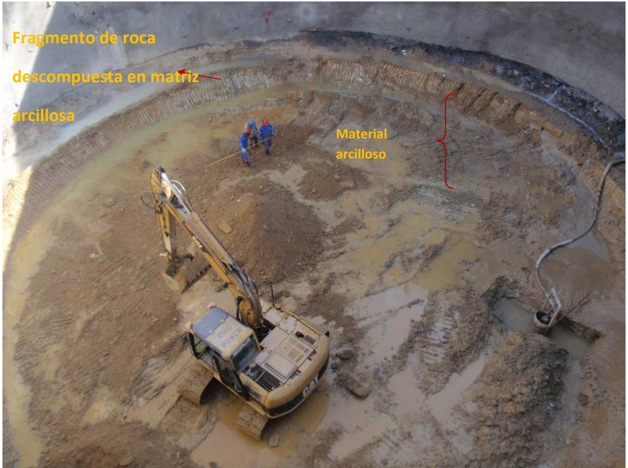
Vista en planta del foso de extracción Miranda II a una profundidad de 22m, el material que se observa es arcilloso hacia el lado derecho de la imagen y al otro lado fragmentos de roca descompuestas en matriz arcillosa.
