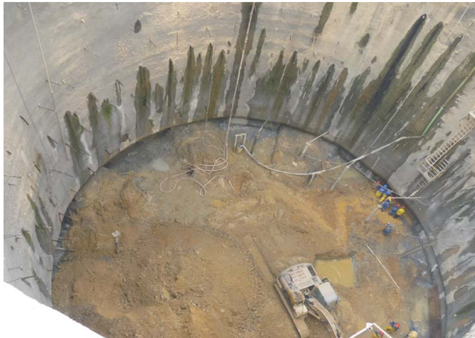
Figura 4.32. Observe en la imagen el foso de Bello campo a una profundidad de 28 metros, note en el núcleo material acumulado de los paneles excavados en presencia de agua descargada por los geodrenes.
