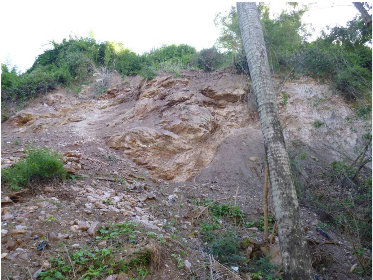
Figura 4.3. Talud de corte en la avenida AC de la urbanización Caurimare con evidencias de desprendimientos de troncos, ramas, movimientos de cantos y fragmentos de material rocoso meteorizadas.
