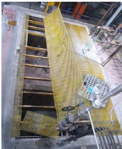
Figura A- 2. Tanque de Neutralización.
