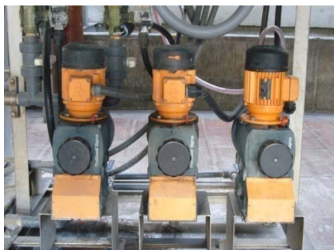
Figura A- 5. Bombas de dosificación.
