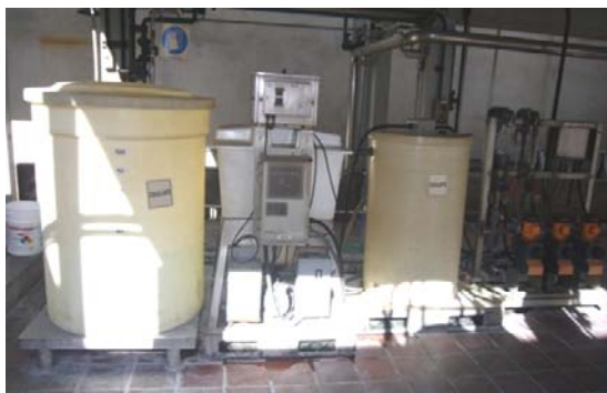
Figura A- 4. Tanques de preparación de coagulante y floculante.
