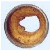
Figura 7. Incrustación Calcárea en Tuberías de Producción.
