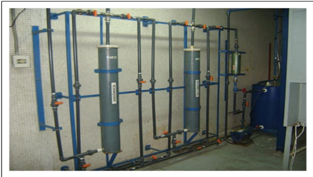
Figura 42. Planta Desmineralizadora de Agua.
