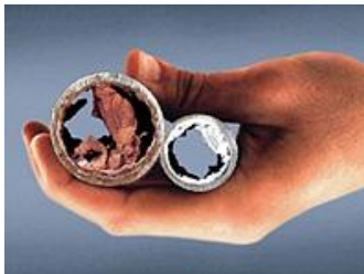
Figura 2. Tuberías Incrustadas Producidas por Aguas Duras.
