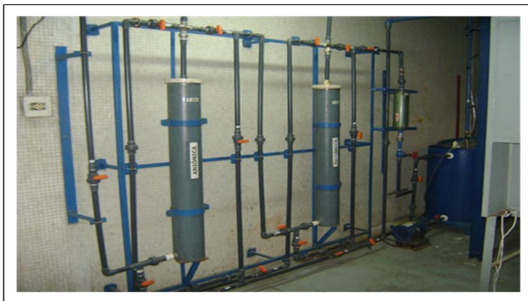
Figura 42. Planta Desmineralizadora de Agua.
