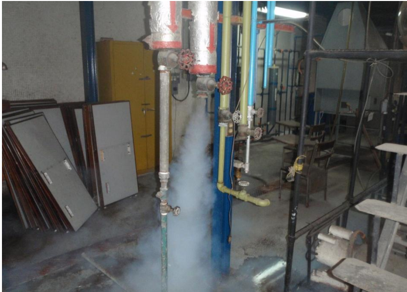
Figura N° 20 Presencia de vapor en tuberías del LOU
