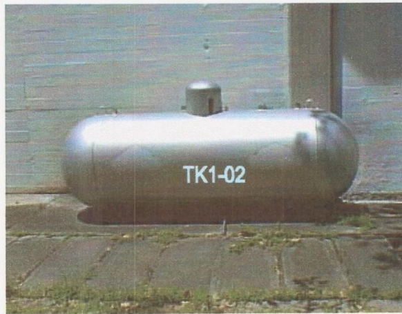
FIG.11.A. Tanque de Almacenamiento de Combustible.
