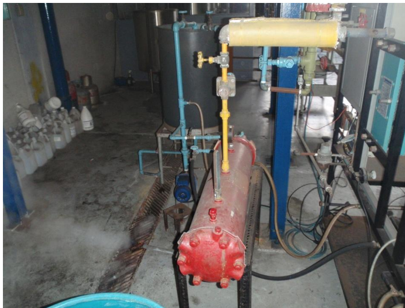
Figura N° 21 Intercambiador de calor para realización de práctica.
