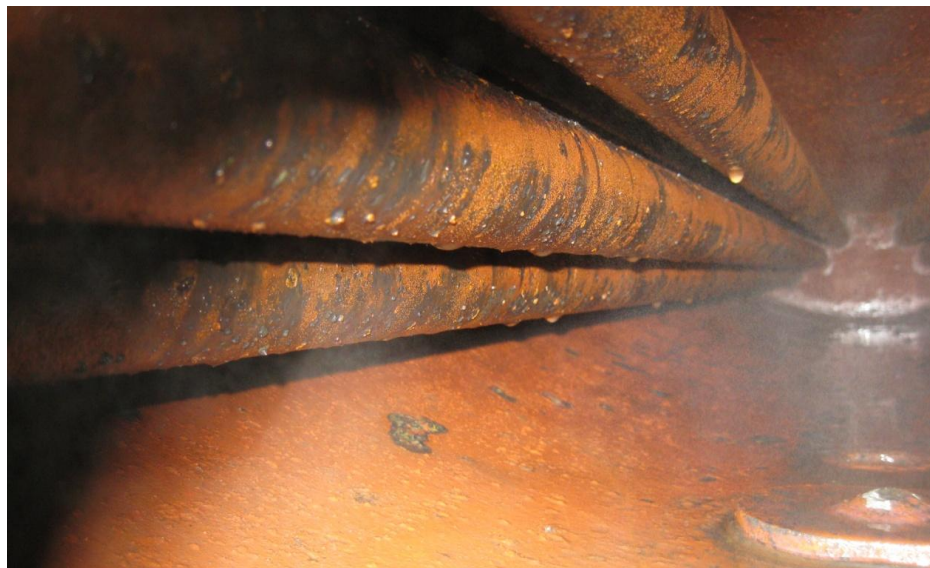
Figura N° 6. Efecto de la Corrosión en tubos. (Tomada de la caldera de LOU).
