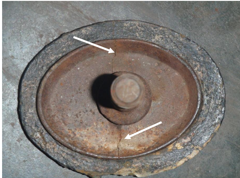
Figura N° 14. Grietas en registro de mano
