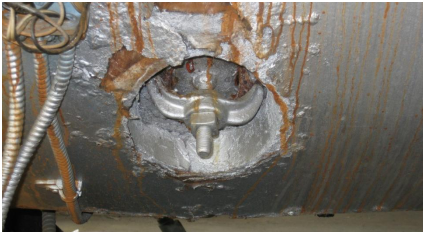
Figura N° 11 Deterioro en cuerpo de la caldera
