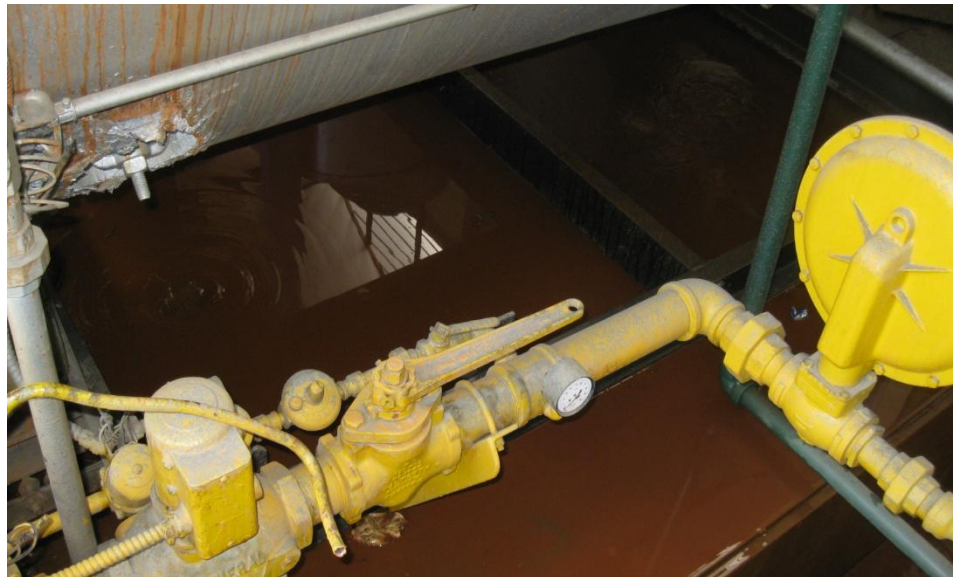
Figura N° 13. Estado del tren de gas.
