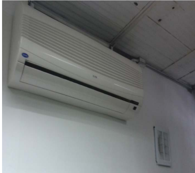
Figura 10. Aparato de aire acondicionado y extractor de aire
