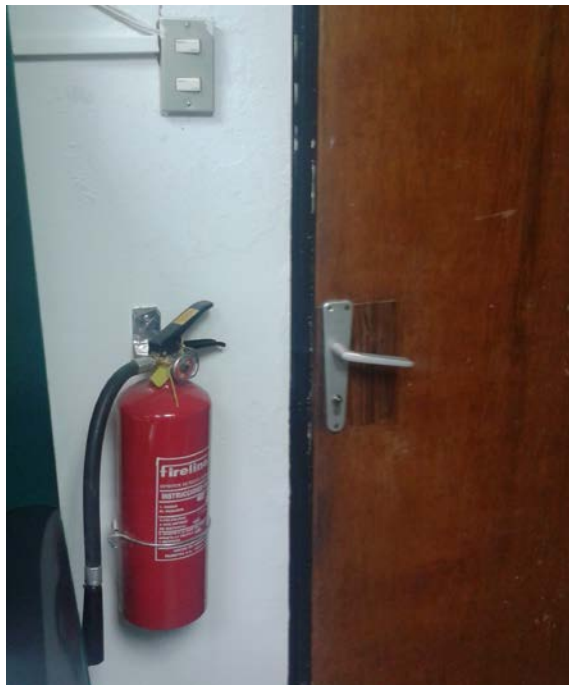
Figura 12. Extintor ubicado en la entrada del Archivo General
