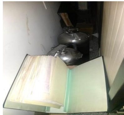
Imagen 22. Documentos encima de extintores de incendios.
