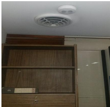
Imagen 21. Detectores de humo. No funcionan.
