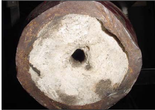
Figura 6. Tubería con incrustación de \text{CaCO}_3 proveniente de un pozo productor del Oriente del país
