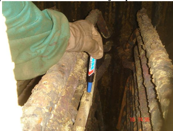
Figura n° 24 Detalle de la ubicación del tubo del sobrecalentador primario analizado en este Trabajo Especial de Grado (tubo n° 4, serpentín n° 10).
