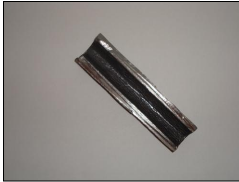
Figura n° 31 Detalle de la parte interna de un tubo del sobrecalentador primario.
