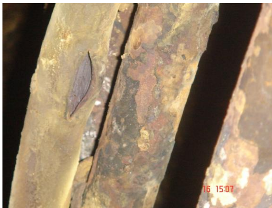
Figura n° 25 Falla presentada en el tubo del sobrecalentador primario estudiado en el presente Trabajo Especial de Grado (tubo n° 4, serpentín n° 10).
