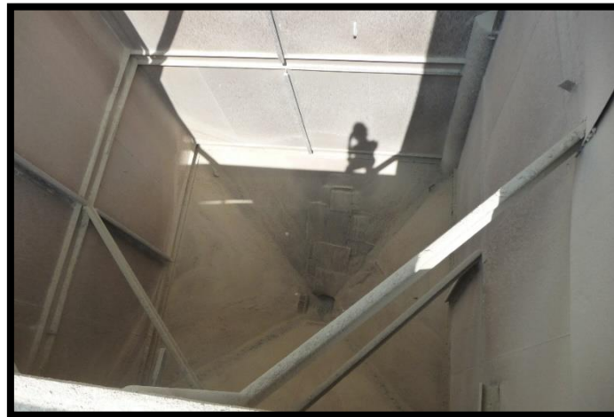
Figura 5. 10 Tolvas de descarga de producto terminado Fuente: Por el autor, Canteras Cura C.A, 2016
