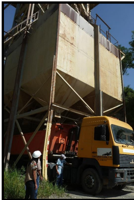
Figura 5. 11 Tolvas de descarga de producto terminado Fuente: Por el autor, Canteras Cura C.A, 2016
