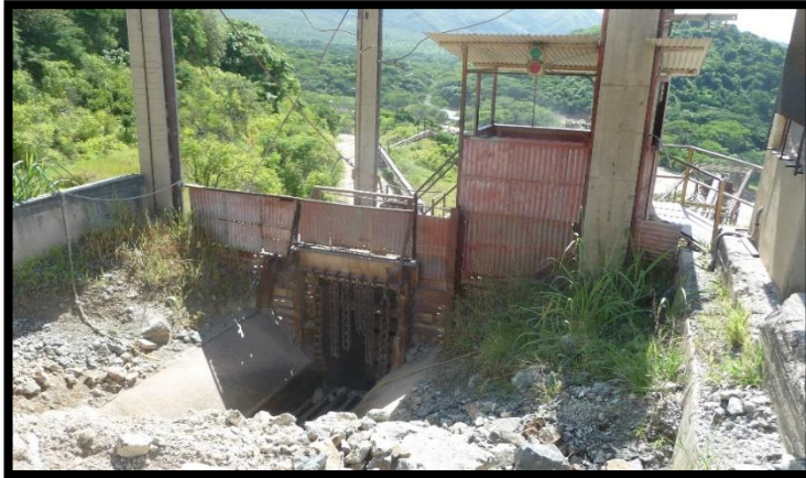
Figura 5. 6 Grizzli, planta primaria, descarga directa por camiones
