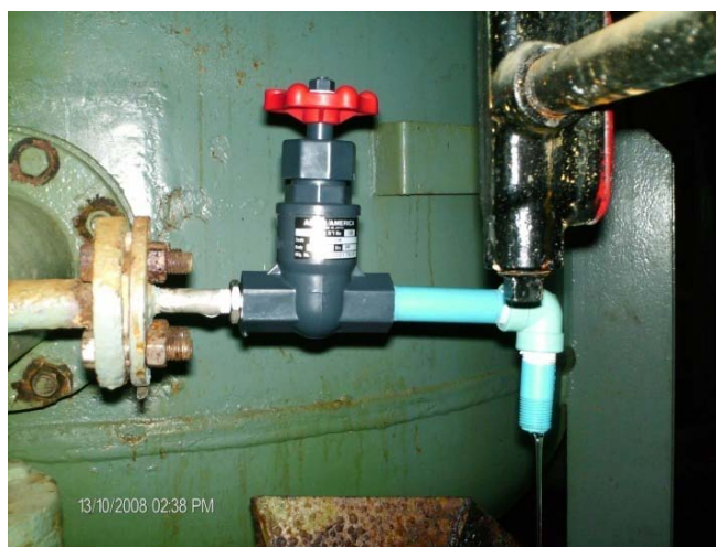
Figura 48. Tomamuestras de la Entrada del Intercambiador Catiónico Fuerte.
