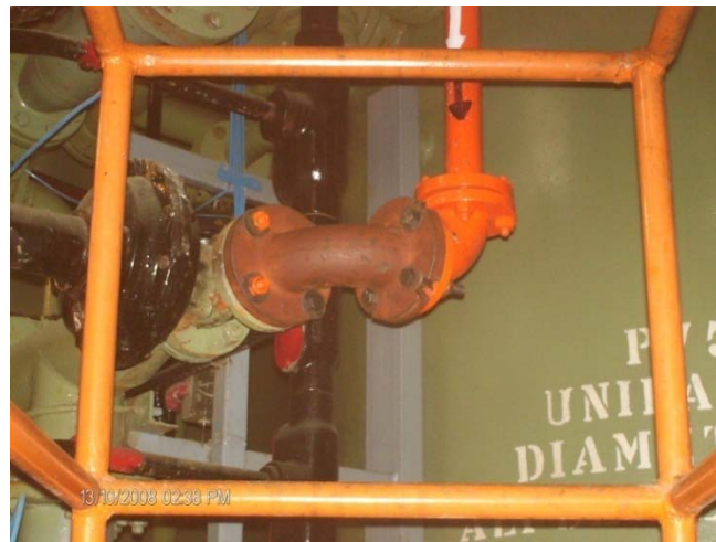
Figura 50. Codo Reparado del Intercambiador Catiónico Fuerte.
