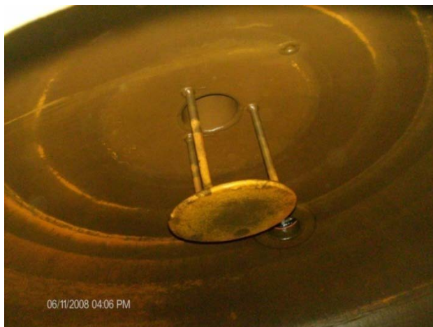
Figura 56. Deflector de los Intercambiadores.
