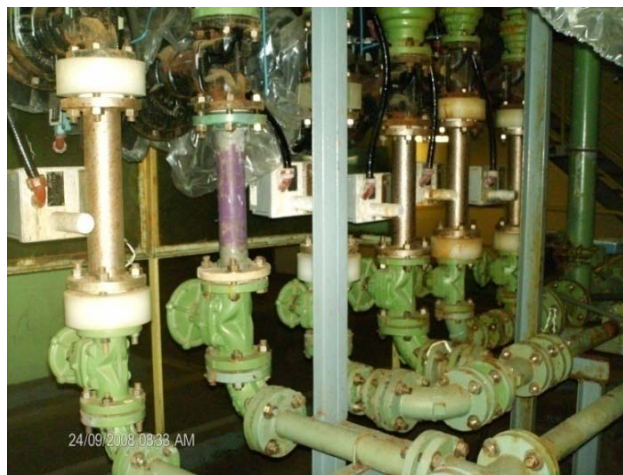
Figura 42. Estación de Dilución.
