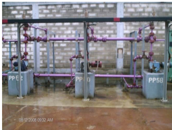
Figura 37. Bombas de Ácido Clorhídrico en el Patio de Tanques.
