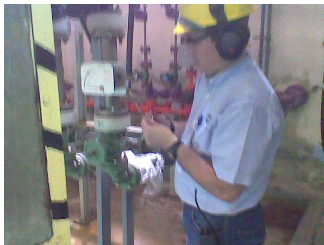
Figura 45. Revisión de los Rotámetros en la Estación de Dilución.
