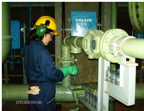
Toma de muestras a la Salida del Intercambiador Catiónico Fuerte C1.
