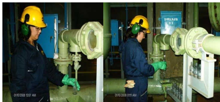
Figura 13. Toma de muestras a la Salida de los intercambiadores
