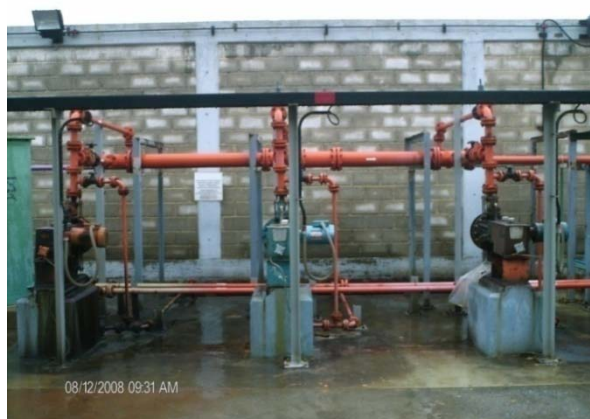
Figura 38. Bombas de Hidróxido de Sodio en el Patio de Tanques.
