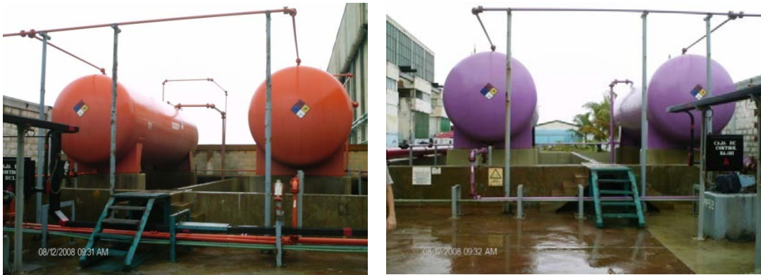
Figura 29. Tanques de Ácido Clorhídrico (anaranjado) e Hidróxido de Sodio (morado).
