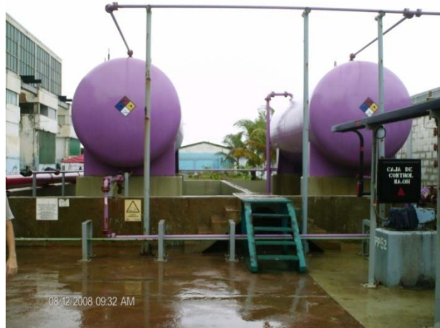
Figura 40. Tanques de Hidróxido de Sodio.
