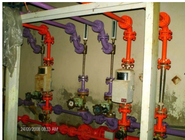
Figura 41. Estación de Dilución de Regenerantes.
