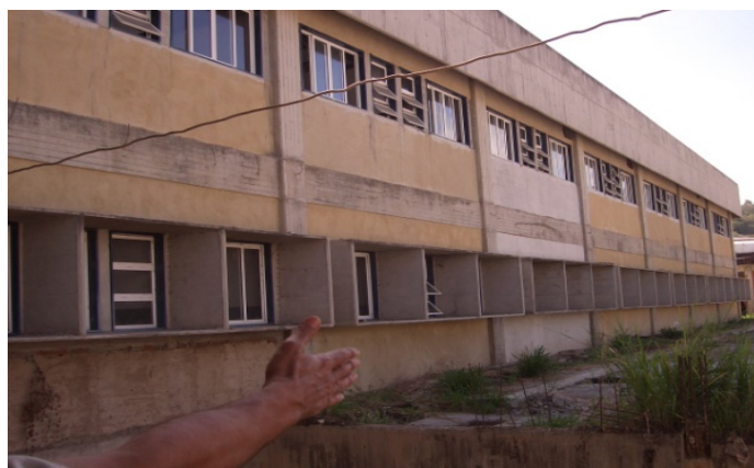
Figura 8: Obras inconclusas del Hospital Oncológico de Guarenas. Inicio 1985 Foto: de autor.
