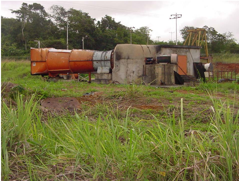
Figura 5. 16 Ventiladores de extracción del pozo Mocupia
