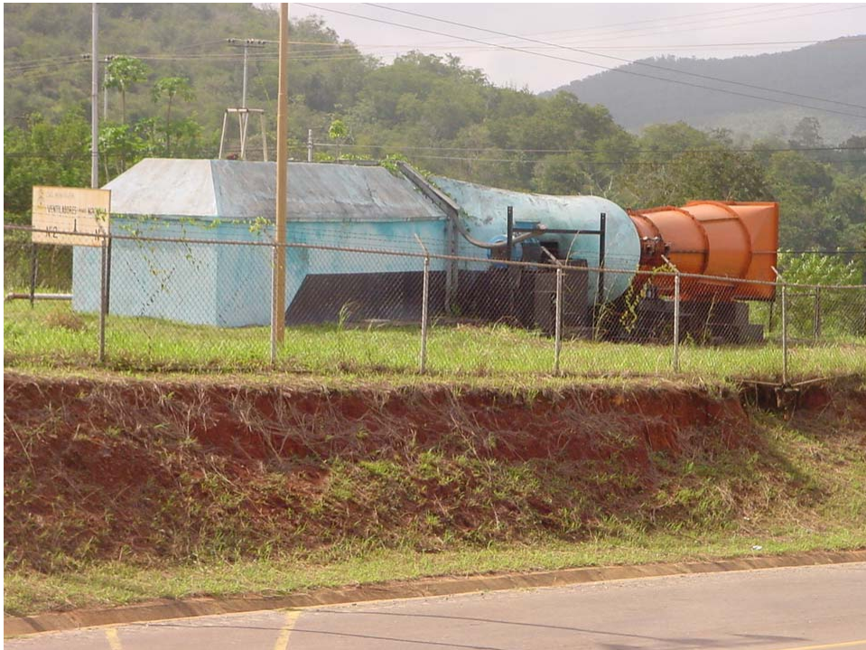
Figura 5. 15 Ventiladores de extracción del pozo América
