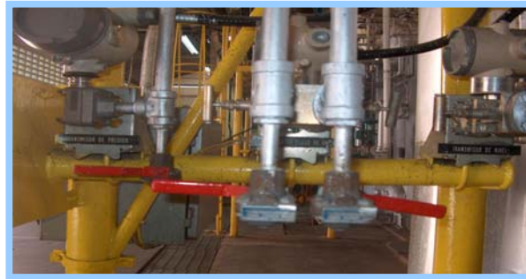
Figura 18. Sensores para el control de nivel en la Caldera N°6.
