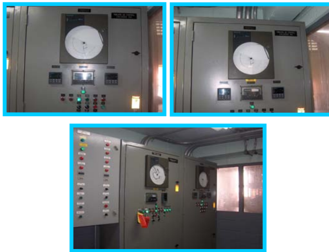
Figura 20. Panel de control de la sala de calderas.
