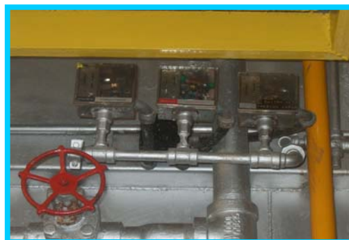
Figura 21. Sistema de supervisión y disparo de la caldera N° 6.
