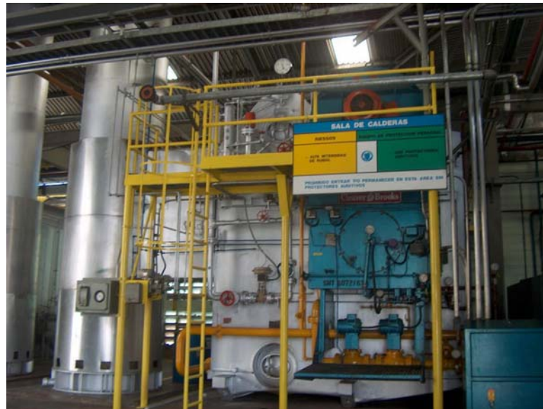
Caldera N° 6 de Remavenca.
