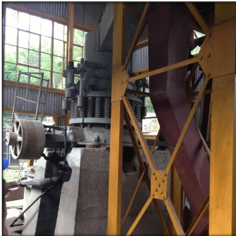
Figura 52. Fotografía del cono de trituración primaria. Fuente propia (2013).
