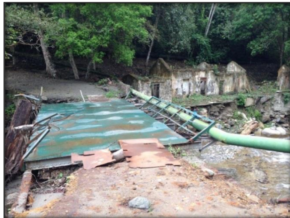
Figura 59. Fotografía del puente destruido. Fuente propia (2013).
