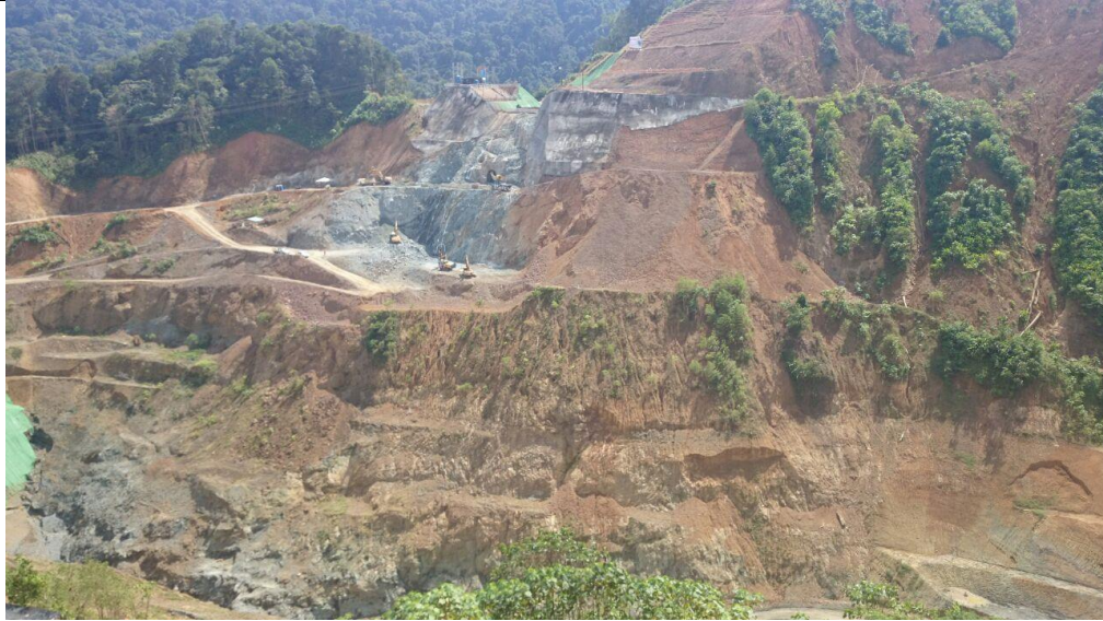
Figura 5. Zona del estribo izquierdo de la presa sobre el río Cuira (fuente propia).
