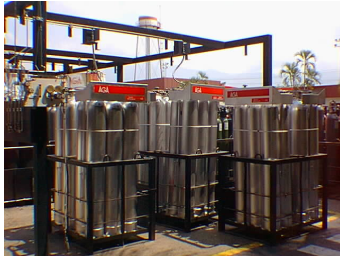
Figura 21. Bancos que conforman el Sistema de Suministro de CO 2
