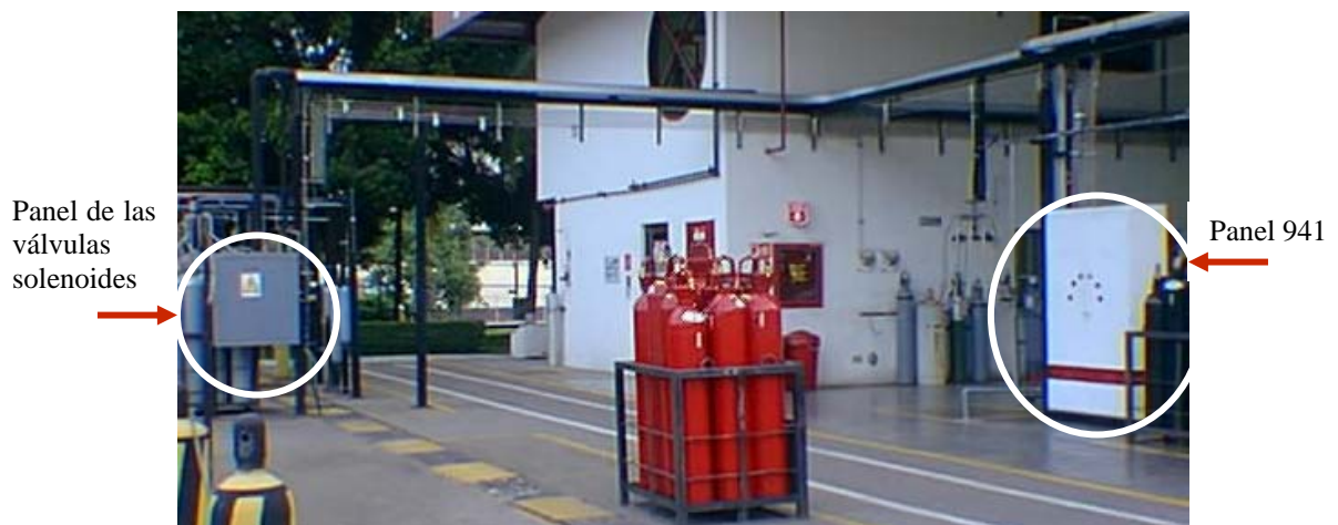
Figura 48. Ubicación del panel de las válvulas solenoides
