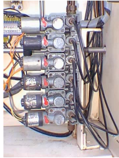
Figura 23. Disposición original válvulas solenoides Panel 921
