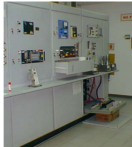
Figura 55. Panel Central de Laboratorio con despliegue del Panel de control
