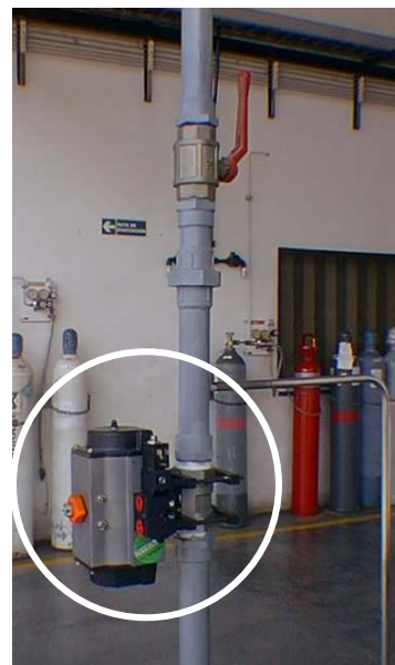
Figura 31. Estructura Actual de la Línea de Vacío
