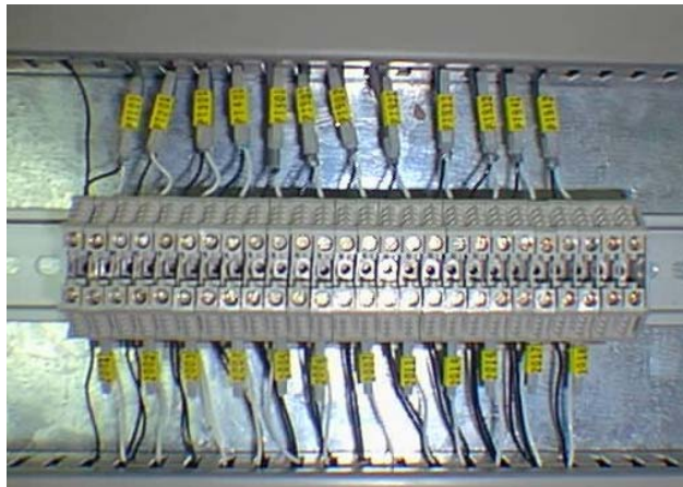
Figura 59. Zona Superior Panel de Control - Borna de los transmisores de presión
