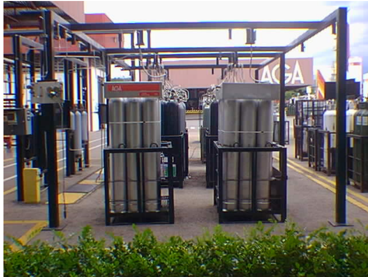
Figura 19. Vista lateral del Sistema de Suministro de CO 2
