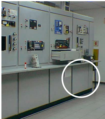
Figura 54. Panel Central de Laboratorio indicando el cubículo del panel de control
