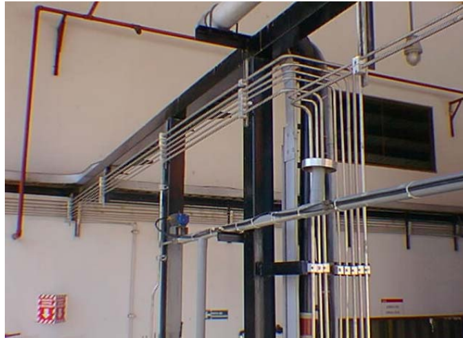
Figura 45. Tendido de tuberías en la parte exterior del Panel 941 y en la Planta
