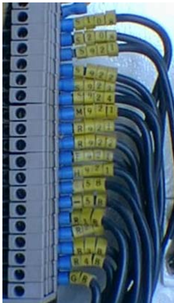
Figura 52. Señalización original de los cables
