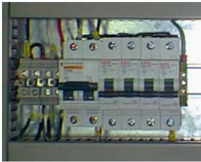
Figura 57. Zona superior - Interruptores de tensión
