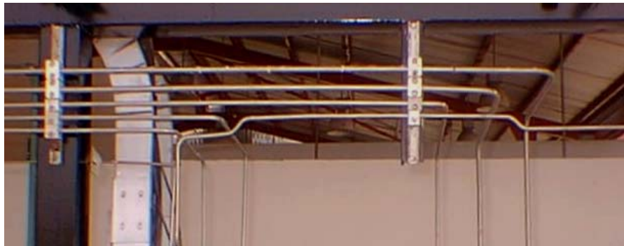
Figura 43. Tendido original de tuberías externas del Panel 941.
