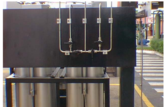
Figura 20. Panel del Sistema de Suministro de CO 2
