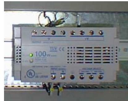
Figura 58. Zona superior - Fuente de alimentación
