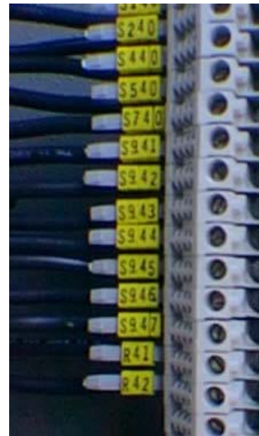
Figura 53. Señalización actual de los cables
