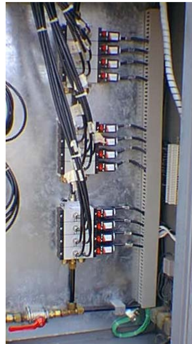
Figura 47. Válvulas solenoides instaladas en el Panel 941
