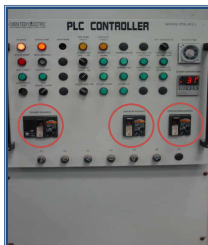
Figura C. Breakers del PLC Controller.
