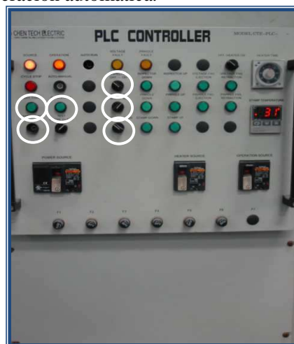
Figura F. Botones de operación automático–manual del equipo.
