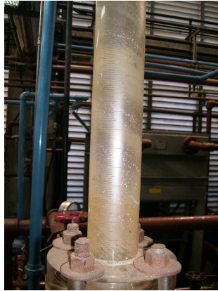
Figura IV.26. Arrastre en Forma de Gotas (Fase II) a través del Tubo de Salida de la Trampa de Líquido
