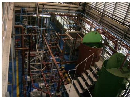
Figura A.2. Módulos de Separación y Bombeo Fuente: PDVSA-INTEVEP, (2008)
