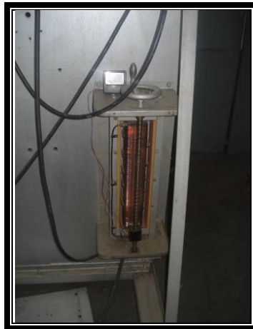
Figura 25. Fotografía de la conexión de la resistencia eléctrica.
