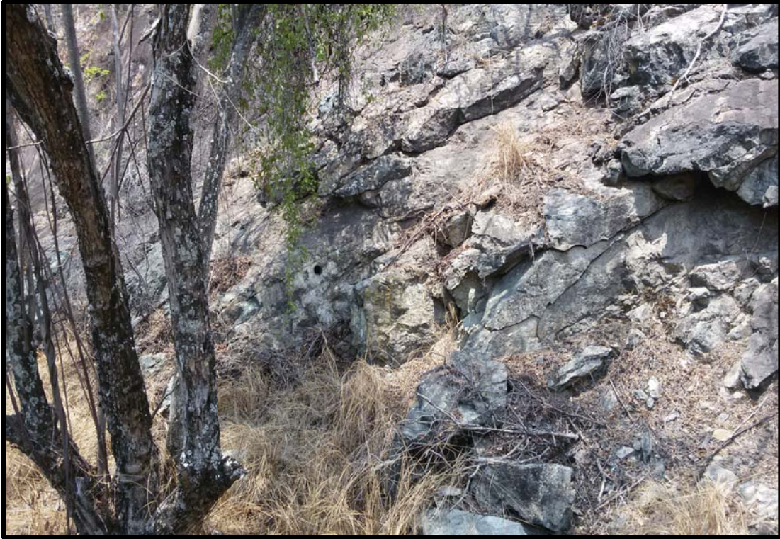
Figura 35. Afloramiento 17, se observa el desprendimiento de bloques y su color verdoso.
