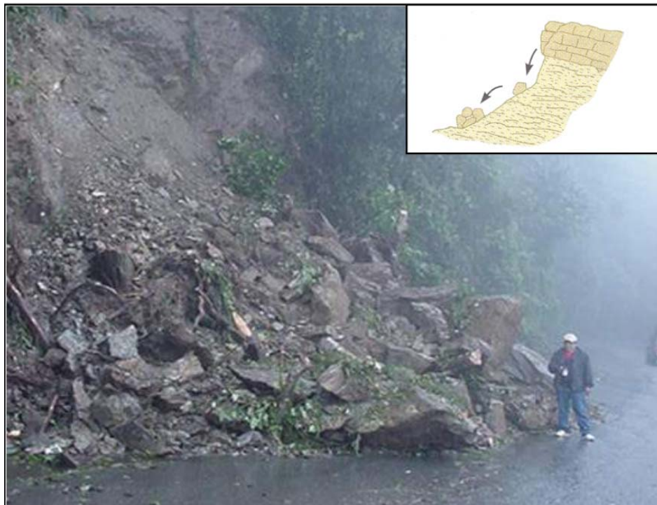
Figura 3.1.8 Desprendimiento rocoso en la vía Puerto Cruz – Colonia Tovar (Cano, 2005).
