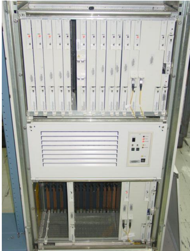
Anexo #3 Equipo AT&T SLM-2000-16
