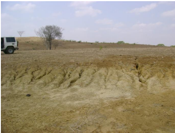
Figura N° 3.3. Zona de erosión concentrada cercana la progresiva 313+800. (Orientación S 15° W)
