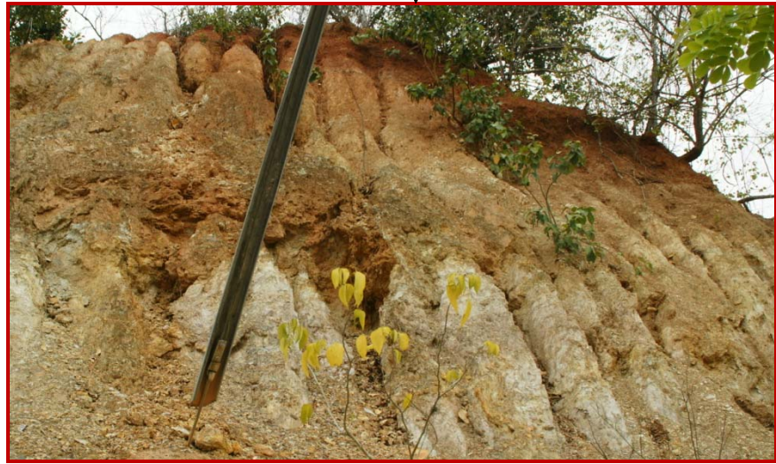
Figura 5.38: Fotos que muestra cárcavas ubicadas en la carretera Cúa – Tácata, Foto superior: vista general, Foto inferior: detalle de las cárcavas.
