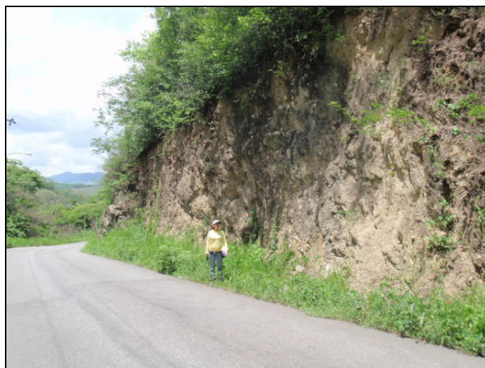
Figura 6.2 : Portal Este Túnel, progresiva Km 69+580 . Afloramiento de Esquistos calcáreos y calizas masivas.
