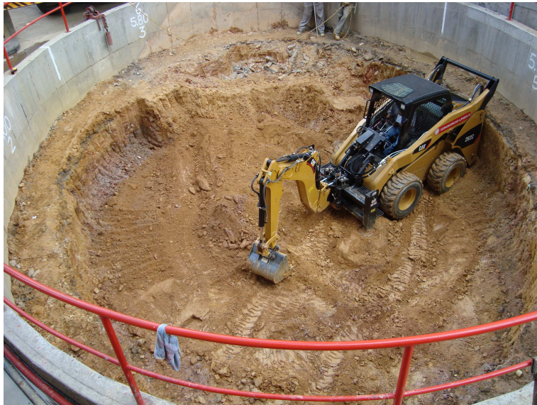
Foto 5.2 Detalle del Foso Andrés Bello (Estación Guaicaipuro) Comienzo de su excavación, Anillo 2. SALOMÓN, 2008.
