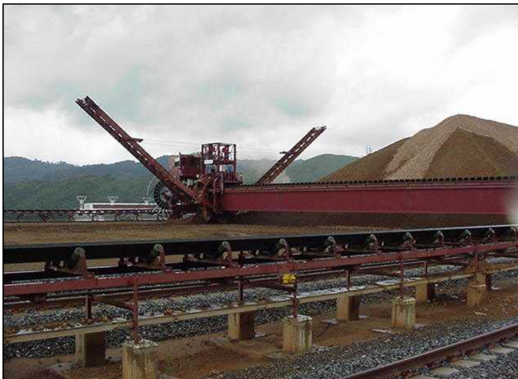
Anexo N° 13. Recuperador en la pila de homogenización. Abajo horno secador
