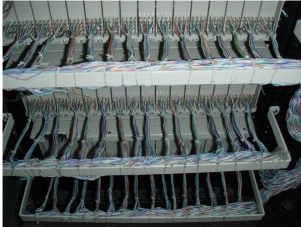
Figura 31: Cableado de E1's en DSX. Estación Bellas Artes.
