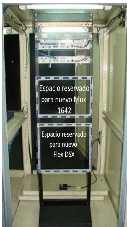
Figura 22: Espacio reservado para Mux y DSX en Los Cortijos.
