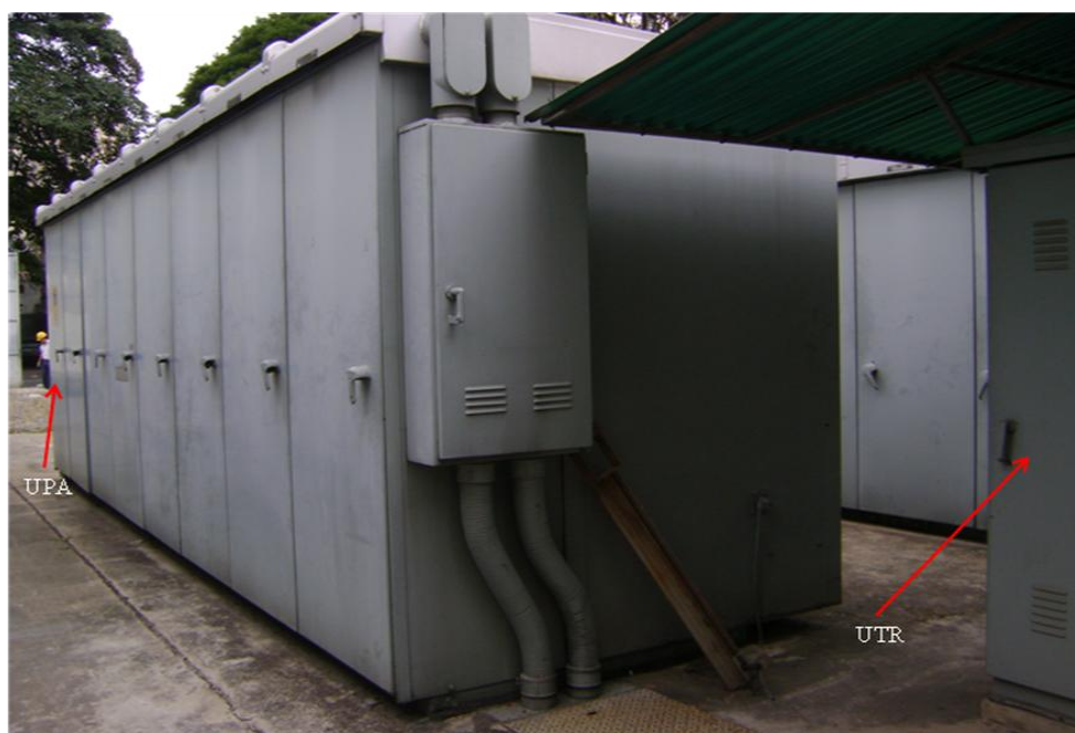
Ubicación de equipos en la subestación.
