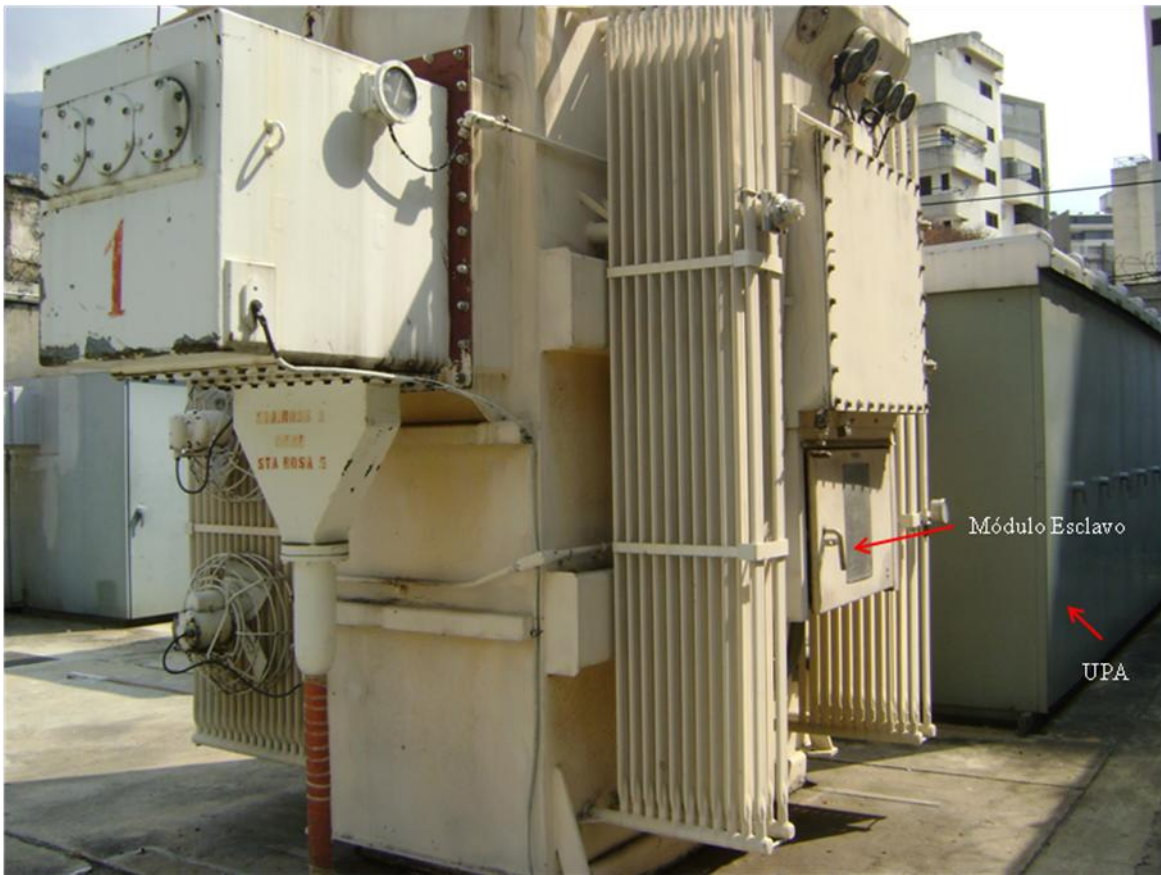
Ubicación de módulos en caja de control de Transformador.
