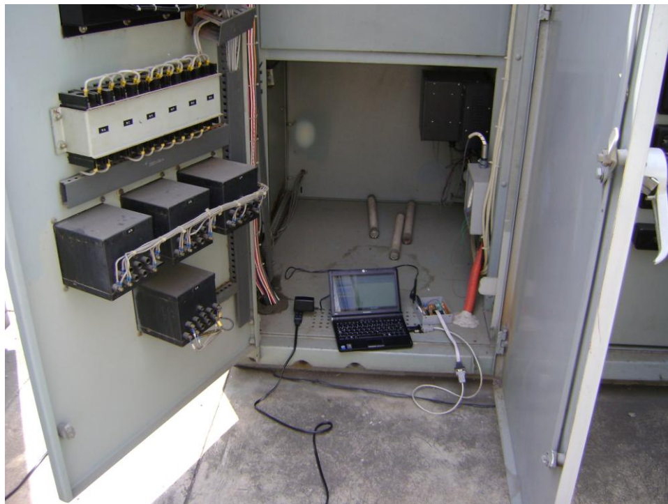
Colocación de Esclavo y Maestro en la ubicación de UPA Y UTR respectivamente.
