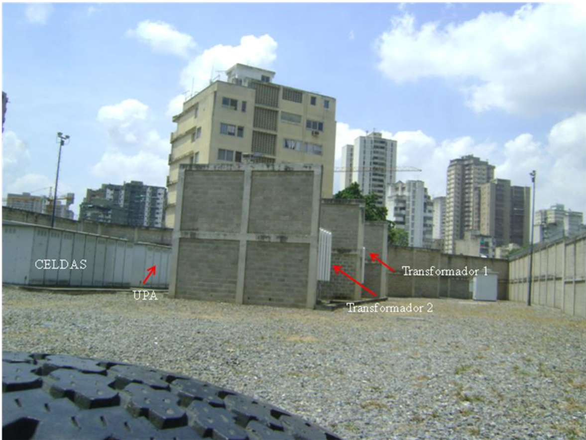
Ubicación de equipos en la subestación.
