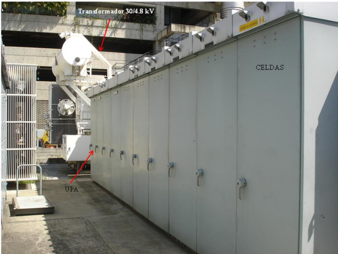
Ubicación de celdas, UPA y transformadores.
