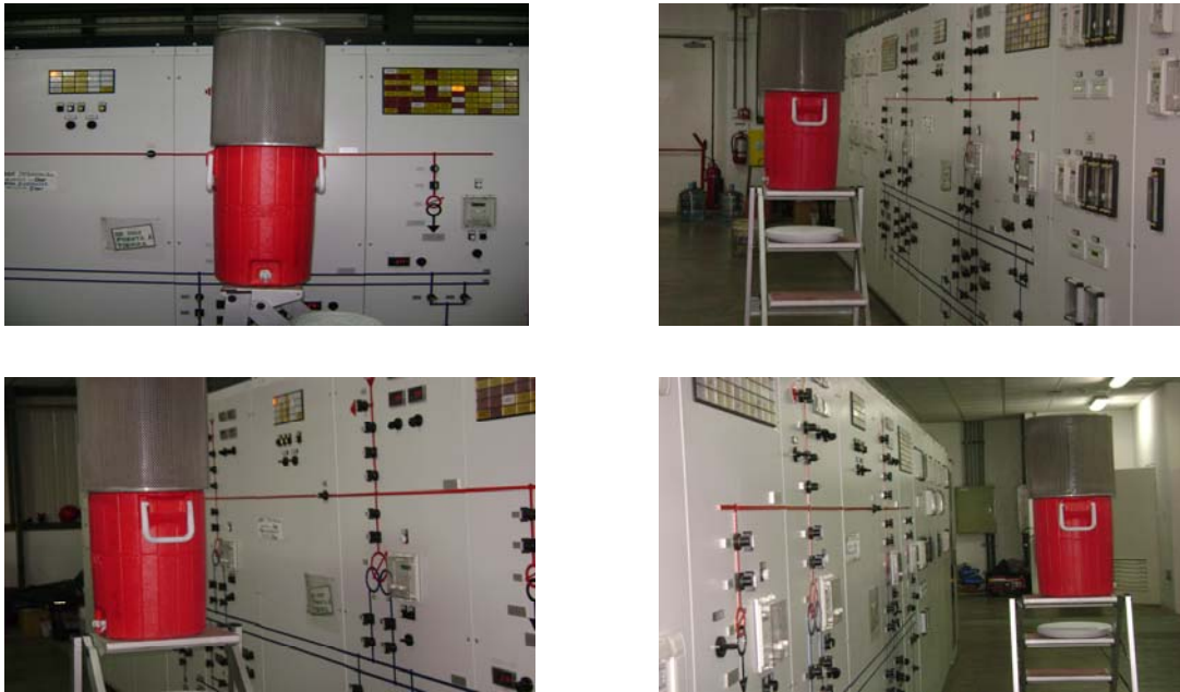
Fig.5.2 Colocación de cámara digital para registro de valores de potencia
