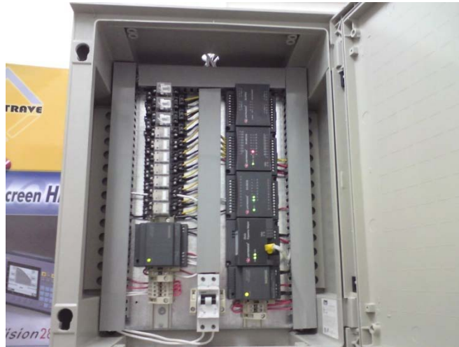
Figura 11: Tablero de Control de la Planta Baja.
