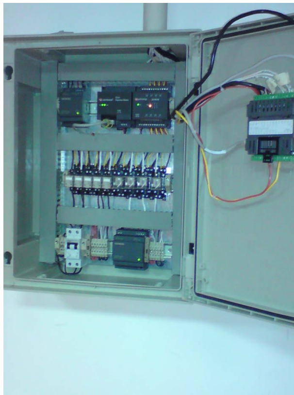
Figura 12: Tablero de Control de la Planta Alta.
