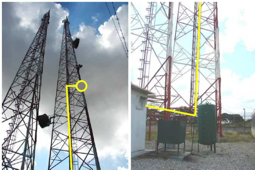
Vista de escalerilla vertical y recorrido de la guía
