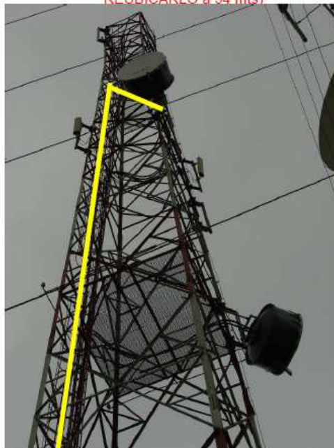
Vista de escalerilla vertical y recorrido de la guía
