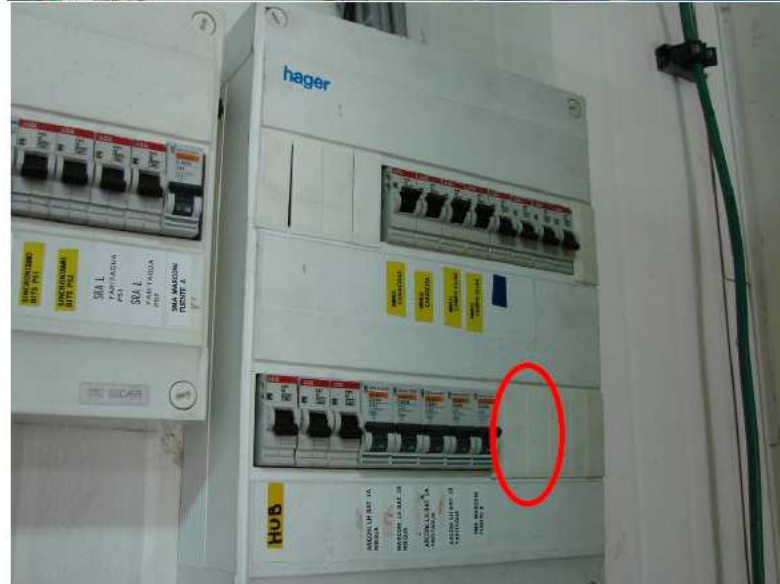
Conexión de radio al PDB. Dos breakers de 32 A
