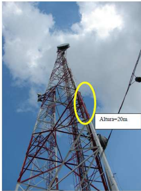
Ubicación de antena en la torre. Arista sur. Azimuth= 242.63°
