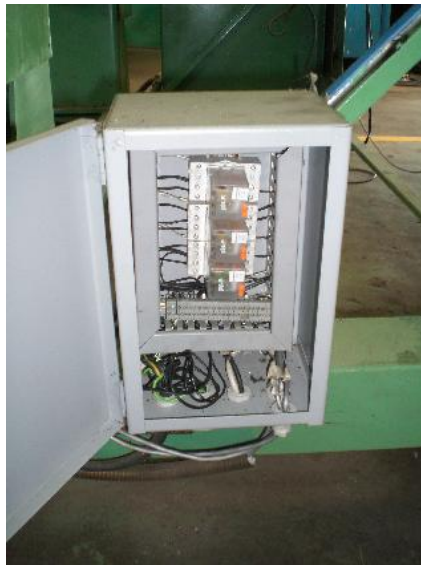
Figura N28. Tablero de fuerza N°2
