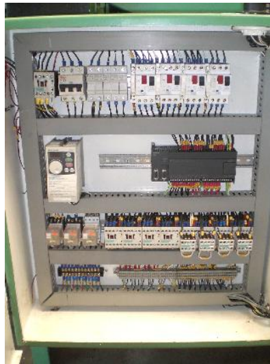
Figura N°26. Tablero de Fuerza
