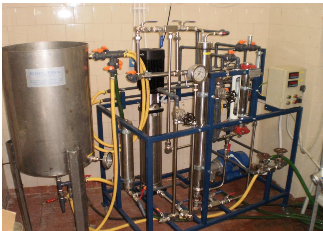
Figura 5.1. Impianto pilota utilizzato per le prove sperimentali.
