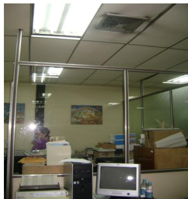
Figura D3-3. Problemas de acumulación de suciedad en las rejillas sobre las oficinas
