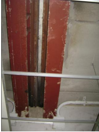
Figura D3-7. Vigas del edificio expuestas
