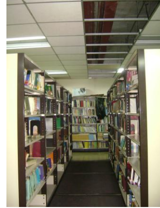
Figura D3-8. Parte de la colección expuesta ante filtraciones de pisos superiores
