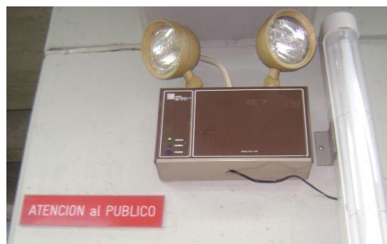
Figura D2-12. Luces de emergencia
