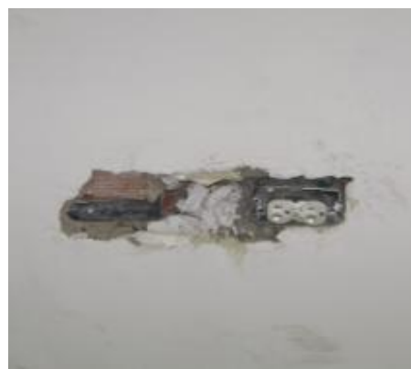
Figura D3-6. Tomacorriente dañado
