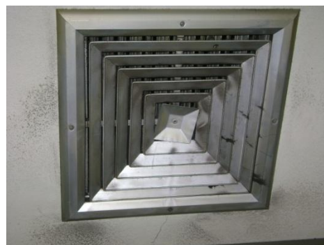
Figura D3-2. Presencia de polvo y suciedad en las rejillas del aire acondicionado
