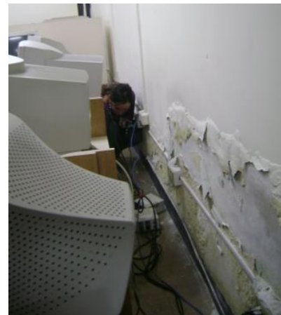
Figura D3-10. Filtraciones en una de las salas: Punto de medición 5
