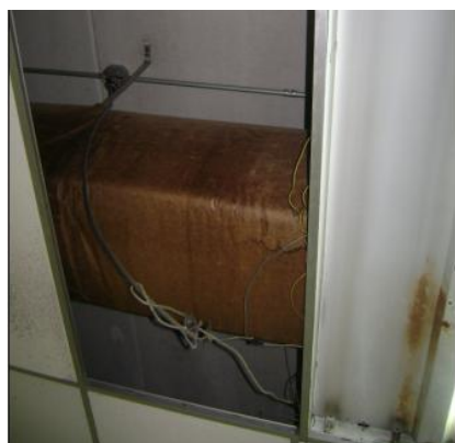
Figura D3-5. Problemas en los ductos de los aires acondicionado y falta de laminas
