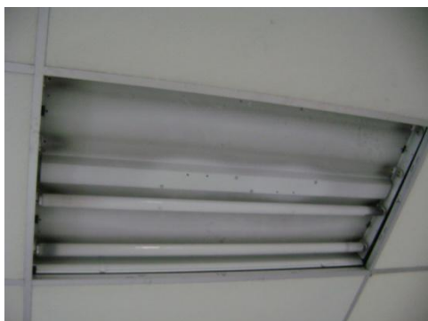
Figura D3-1. Deficiencias en las luminarias
