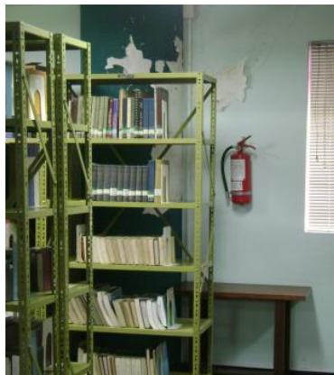
Figura D4-3. Problema de filtración cerca de la colección y del personal
