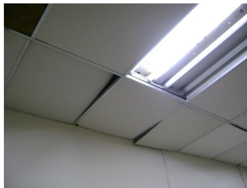
Figura D3-4. Ausencia de filtros UV en las lámparas y cielo raso dañado.
