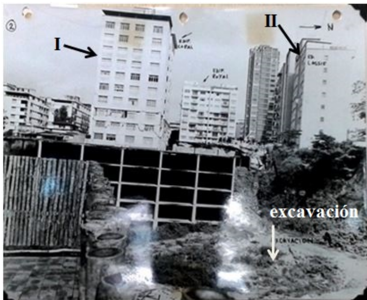
Figura 2.3: Imagen de los escombros del edificio San José que cayeron hacia la excavación.
