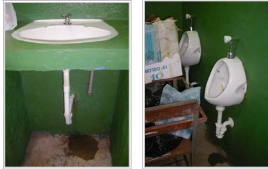
Figura 5.14: Piezas sanitarias del baño
