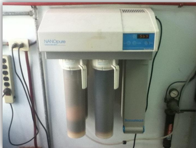
Figura 14. Desionizador de agua
