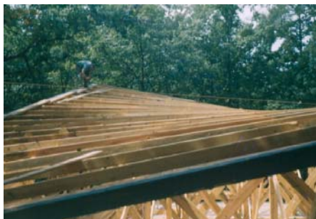
Figura 7. Detalle de los materiales que conforman la cubierta de la casa Raleigh. Fuente: http://www.ncmodernist.org/catalano.htm
