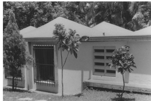
Figura 30. Detalles de acabados de la casa del Arq. Julio Coll Rojas. . Fuente: Cortesía del Sr. Carlos Coll.
