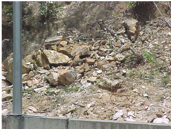
Figura # 35: Bloques desprendidos del afloramiento # 9
