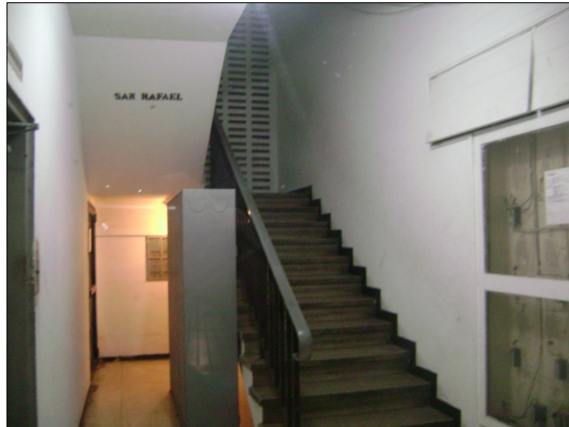
Figura B.7.4: Núcleo de Escaleras y Tablero de Electricidad ausente
