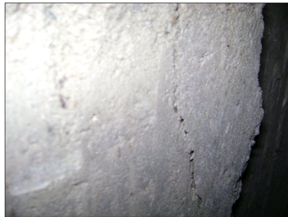
Figura B.2.6: Estado de columna Perimetral en nivel de fundaciones
