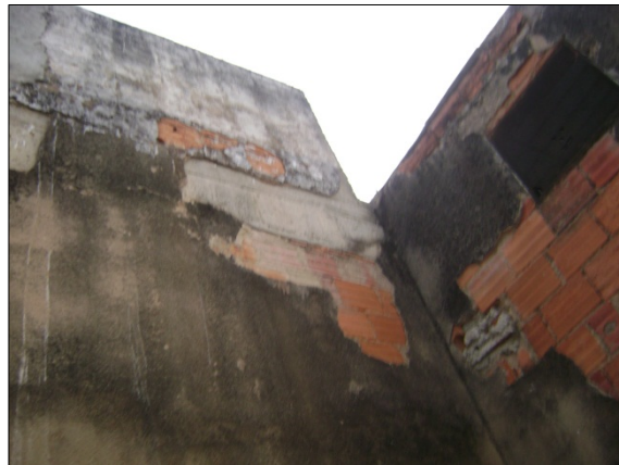
Figura B.9.6: Fachadas internas en estado de deterioro
