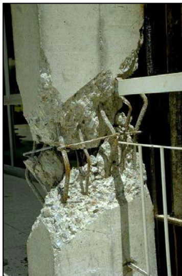
Figura V.7: Falla de una Columna del Edificio Mene Grande por Deficiencia del Confinamiento (Pandeo del Acero Longitudinal y Trituración del Concreto
