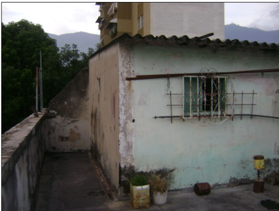
Figura B.9.5: Construcciones improvisadas en la Planta Techo
