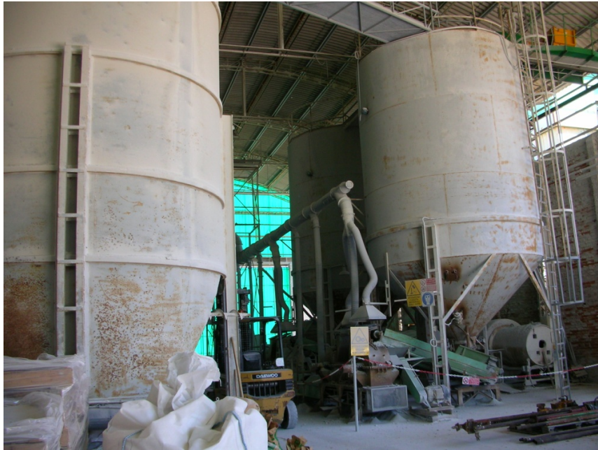
Foto 5: impianto di trattamento
