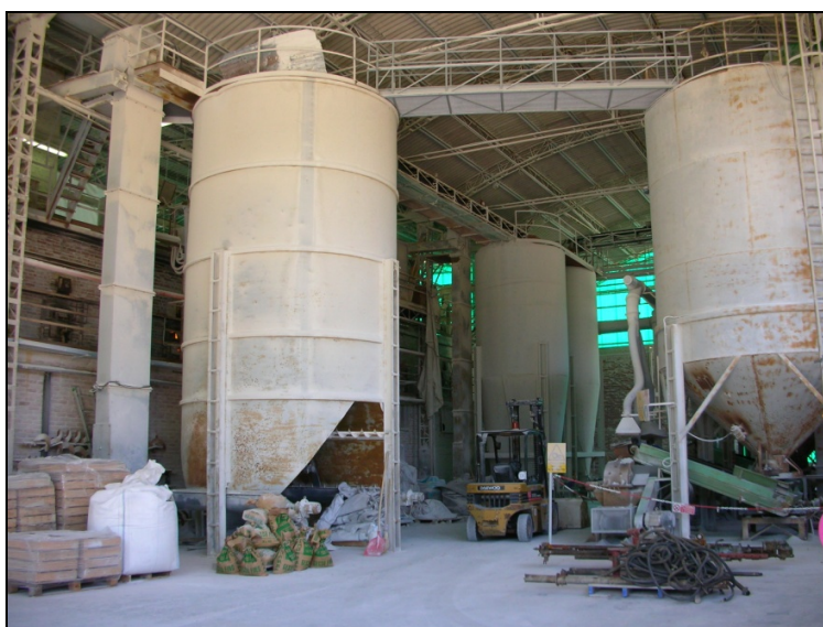
Figura (4.1), impianto di Moncuoco: vista laterale dei forni
