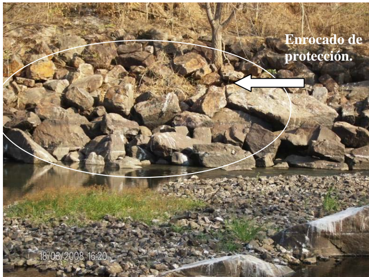
Figura 30. Enrocado de protección en el lecho y en el talud de las márgenes en el río Pao, que va desde el lecho hasta la cota de la terraza donde está ubicada la estación de bombeo de Pao-La Balsa.
