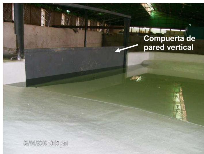
Figura 55. Sistema de control de tirantes ubicado al final del tramo en estudio; compuerta vertical de pared delgada.
