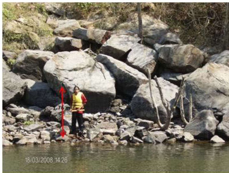
Figura 32. Se observa la magnitud del diámetro del enrocado de protección empleado en las riberas del río adyacente a la estación de bombeo.
